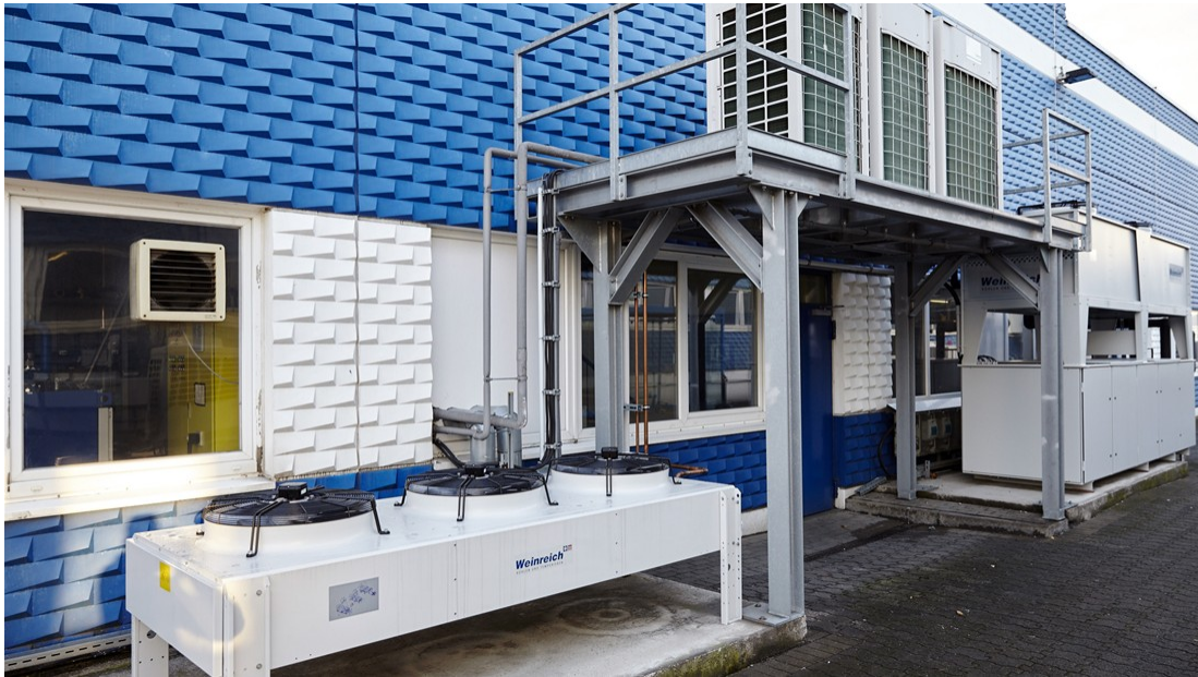
Die Freikühlanlage nutzt die kalte Außenluft zur Kühlung der Maschinen.
